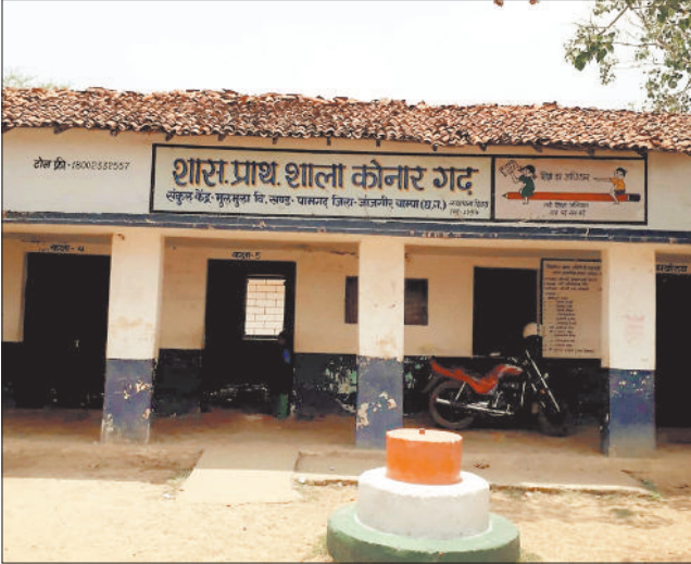
जर्जर स्कूल भवन।
